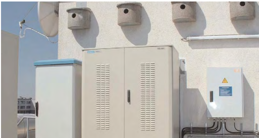
Dachstandort mit Systemtechnik und Zusammenschalteneinrichtung outdoor-fähig im Shelter installiert. Roof site with systems technology and combination system installed in shelter outdoor.
